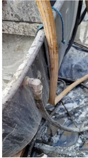
Figura 9. Codo de 90° con manguera de desfogue de agua
